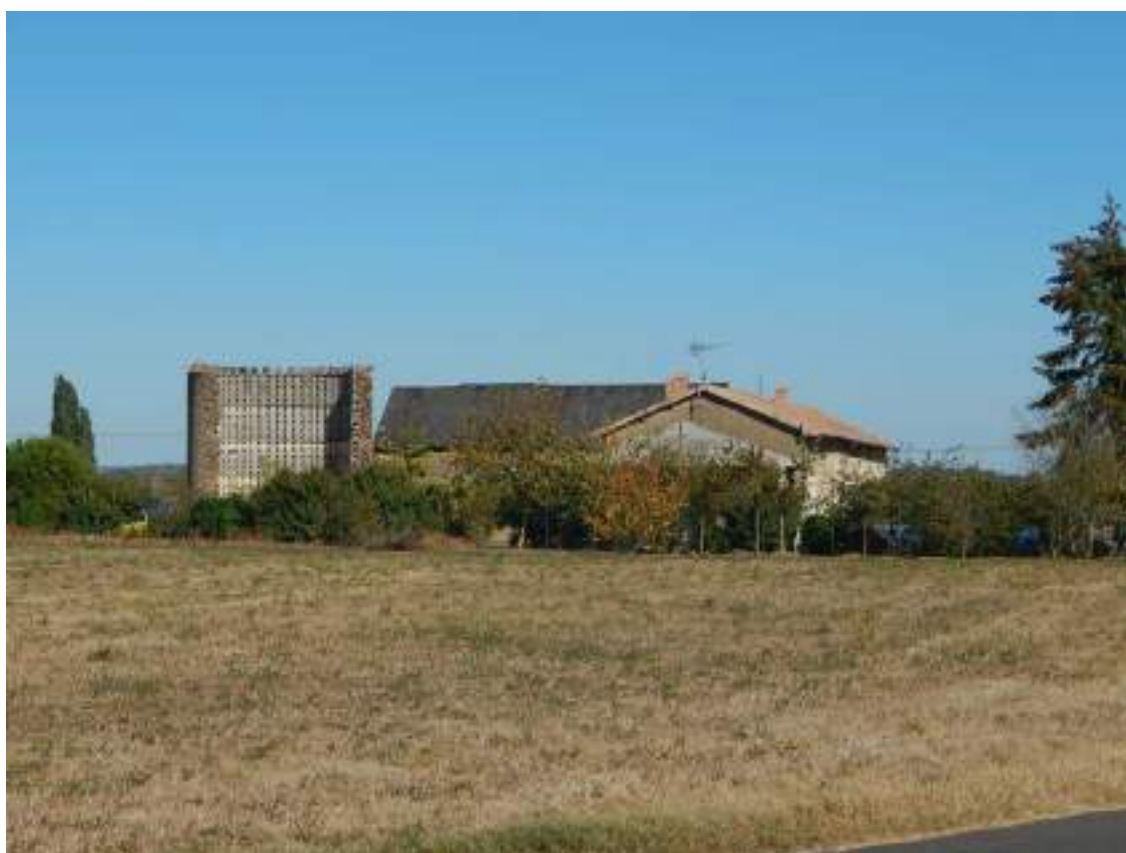
Ancienne ferme de la Grange et son pigeonnier partiellement effondré.
